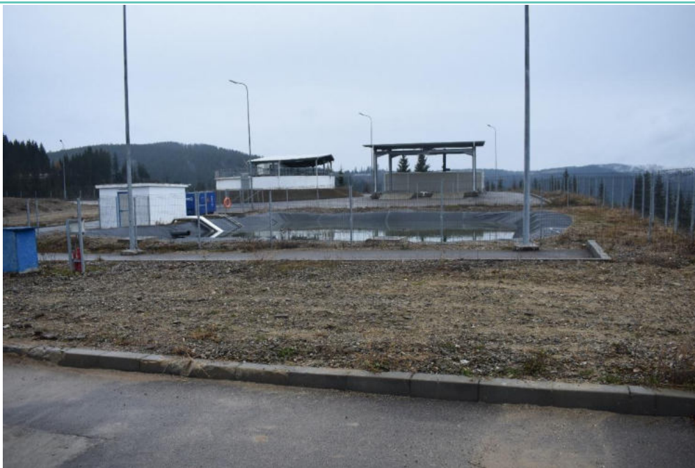
Figura 7 Bazinul de incendiu, statia de pompare si generator electric
