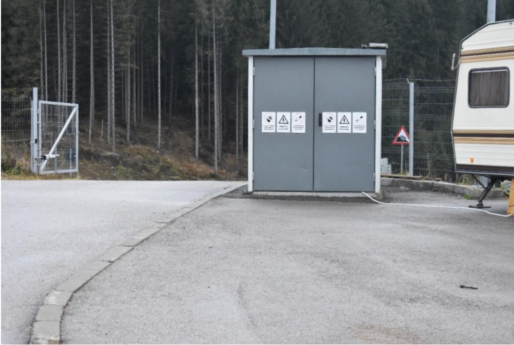
Figura 8 Postul de transformare
