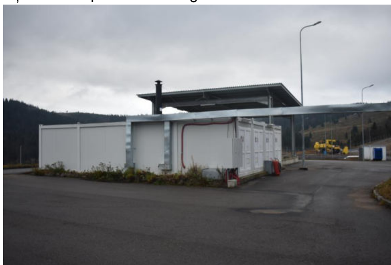
Figura 15 Containerele tehnologice ale stației de epurare
