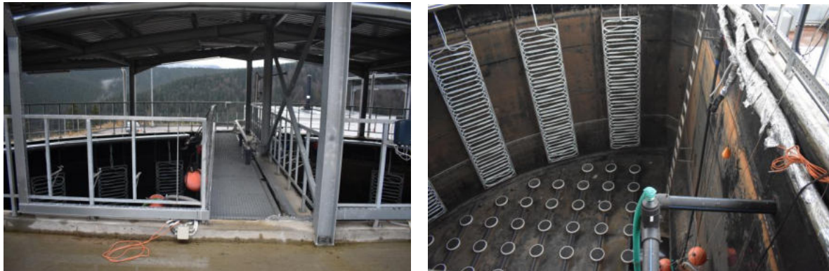
Figura 13 Bazinele SBR ale stației de epurare
