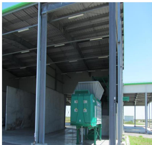
Stația de compostare SC ECO SUD SRL București- Depozit Mavrodin
