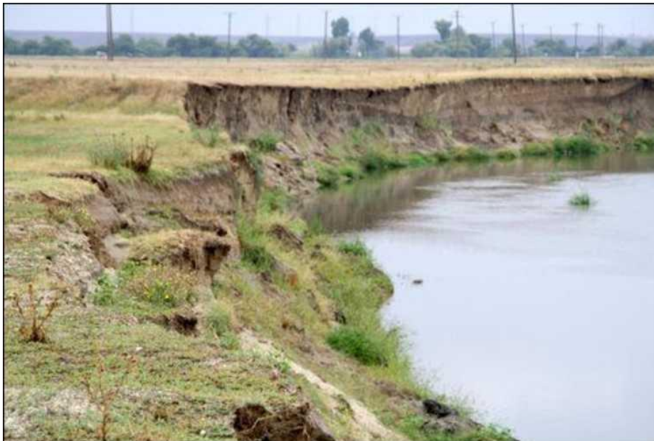
Figura nr. 3 - Aspect privind malul drept al raului Vedea, erodat, imediat amonte de amplasamentul proiectului
