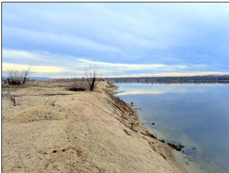
Figura nr. 20 – Aspect privind lipsa de vegetație în zona de ecoton dintre albia minoră și malul albiei majore (vedere spre aval, dinspre malul stâng)
