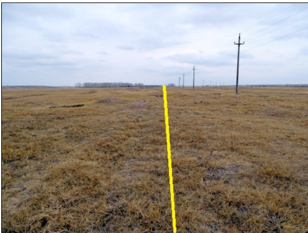
Figura nr. 26 – Aspect privind tronsonul de inlocuire conductă legătură puțuri între puțul nr. 21 și puțul nr. 20
