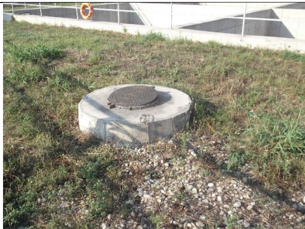
Cămin de vizitare rețea canalizare
