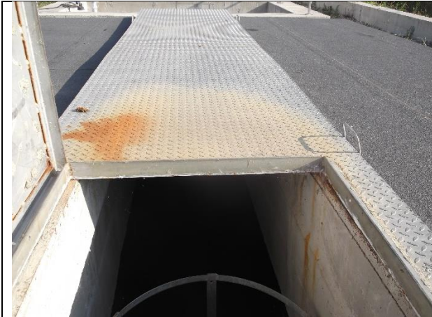
Stație de pompare – acces/vizitare
