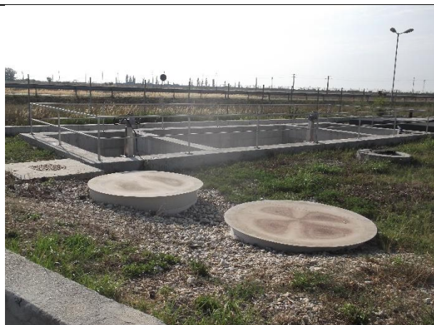
Decantor-separator de produse petroliere și stație de epurare
