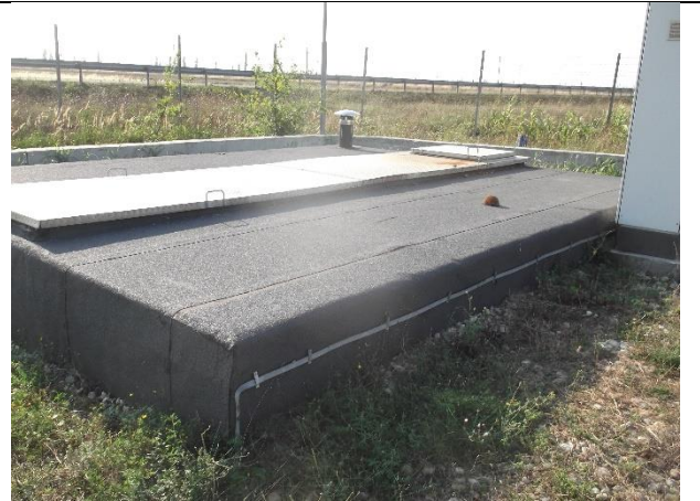
Stație de pompare
