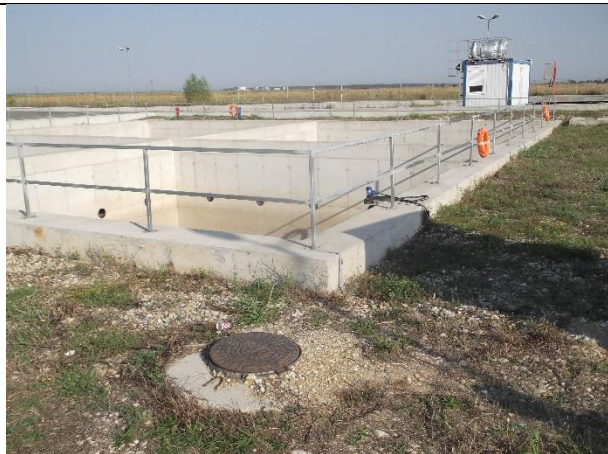
Bazin de colectare – Cămin de vizitare
