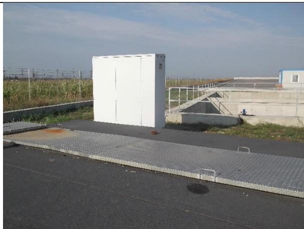
Stație de pompare și cabină comandă
