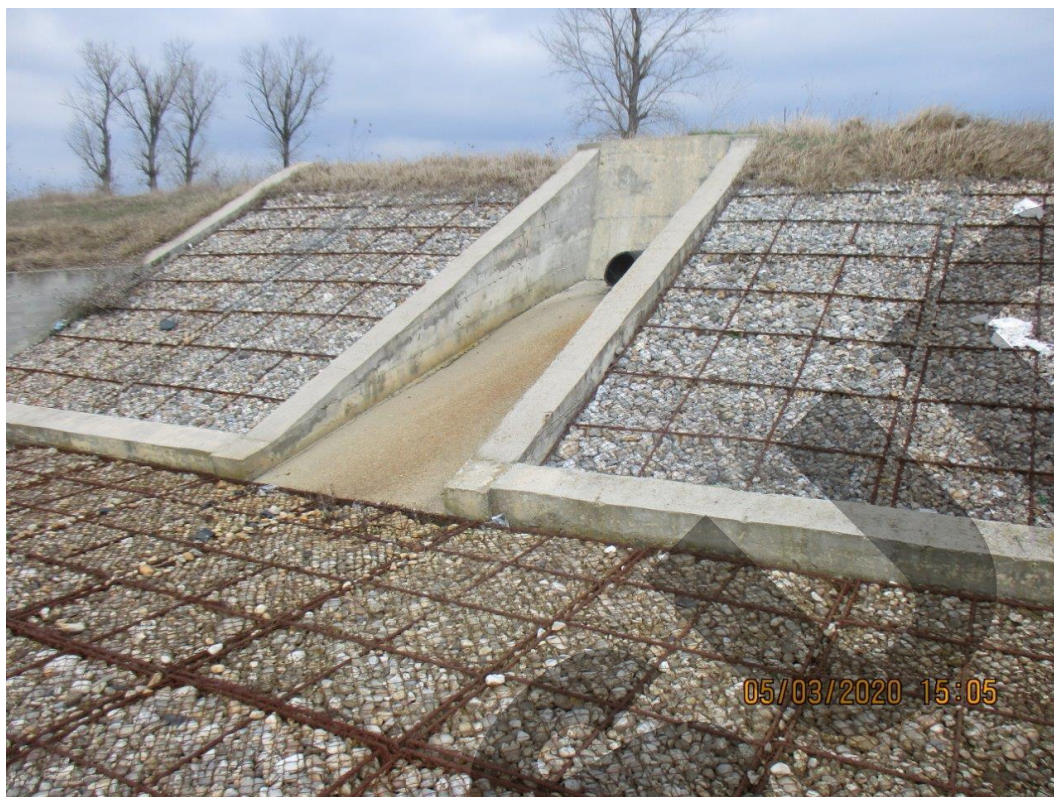
Figura 27. Evacuare ape uzate epurate în Pârâul Cânelui
