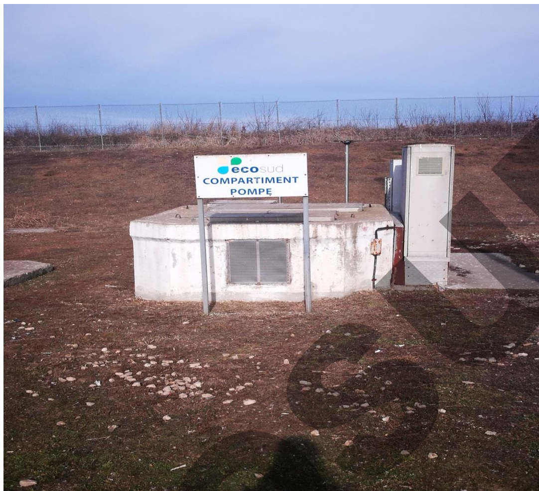
Figura 32. Stația de pompare a apei în pârâul Câinelui
