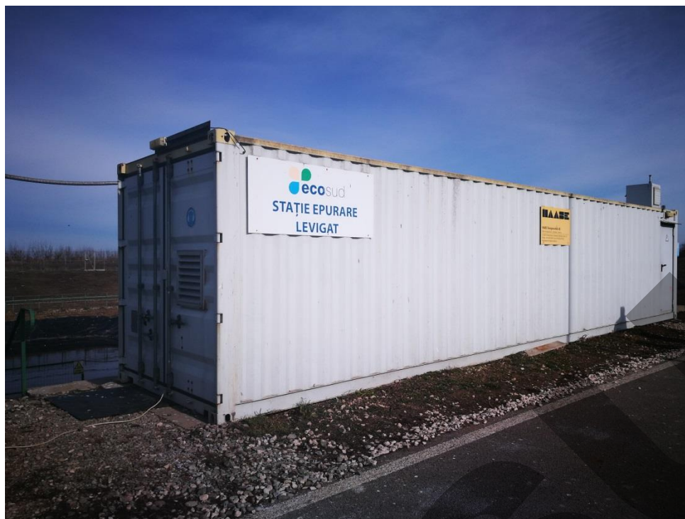
Figura 30. Stația de epurare
