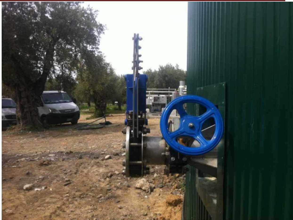
Figura 8. Descărcare forțată digestor
