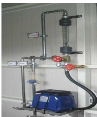
Figura 9. Sistemul de desulfurare
