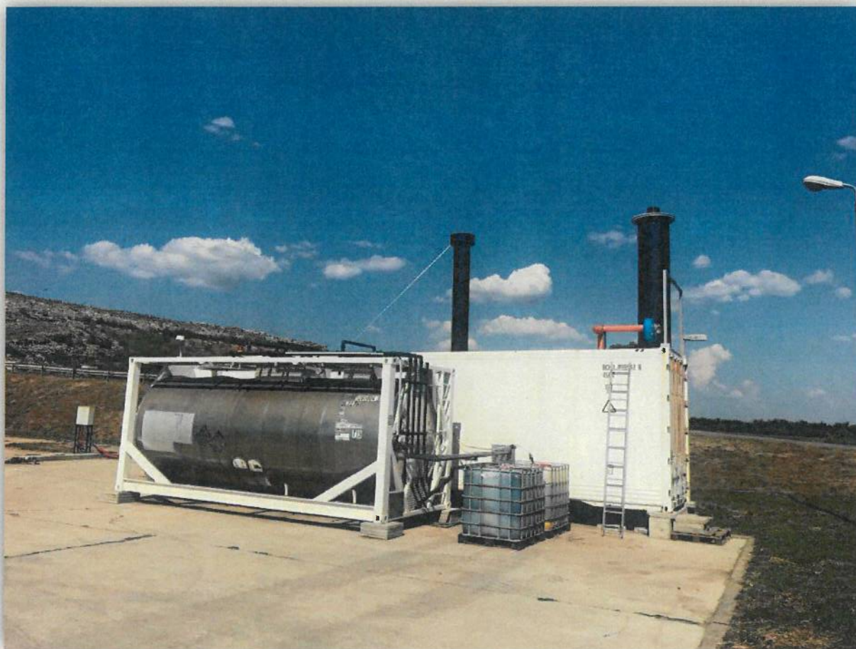
Fig. 7. Zona statie de epurare a levigatului
