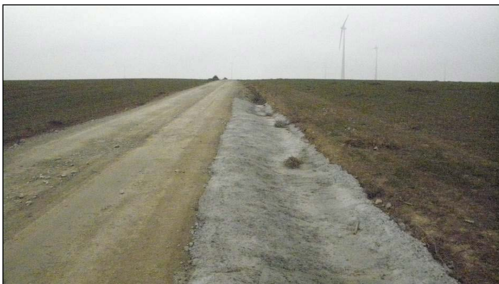
Lucrari de amenajare a sistemului de colectare a apelor pluviale (lunile mai si februarie)
