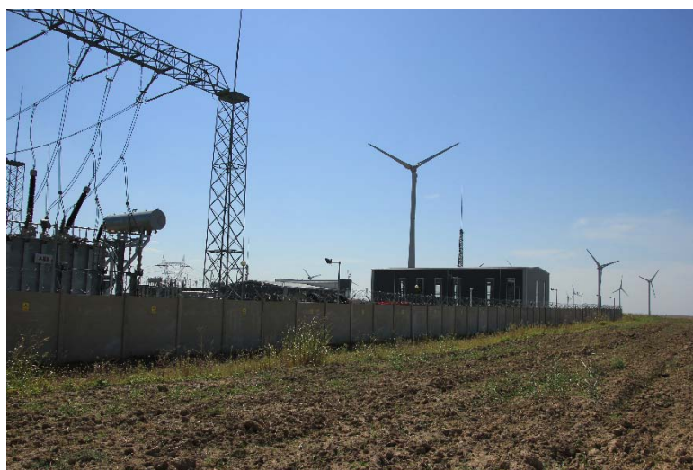
Aspect al statiei de transformare
