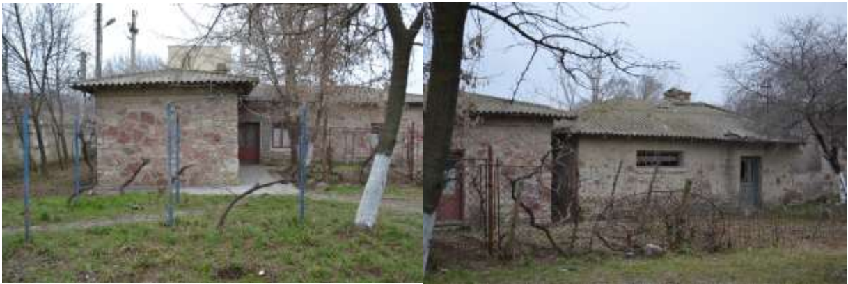
Fig.15-16 cladiri aflate in conservare care sunt acoperite cu placi din azbest
