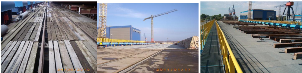
Figura nr. 16. Syncrolift – Inlocuirea platformei din lemn cu gratate metalice tip „Offshore”
