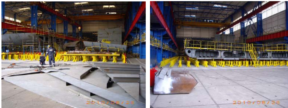
Figura nr. 14. Hala Prefabricare – Inlocuirea patului de asamblare cu sistem asamblare tip Pin-Jig
