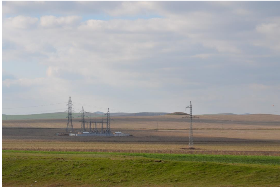
Fig. 7 – statia electrica Zebil
