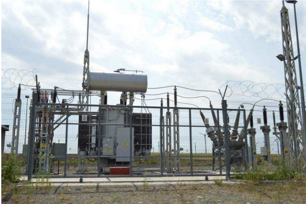
Statia de transformare
