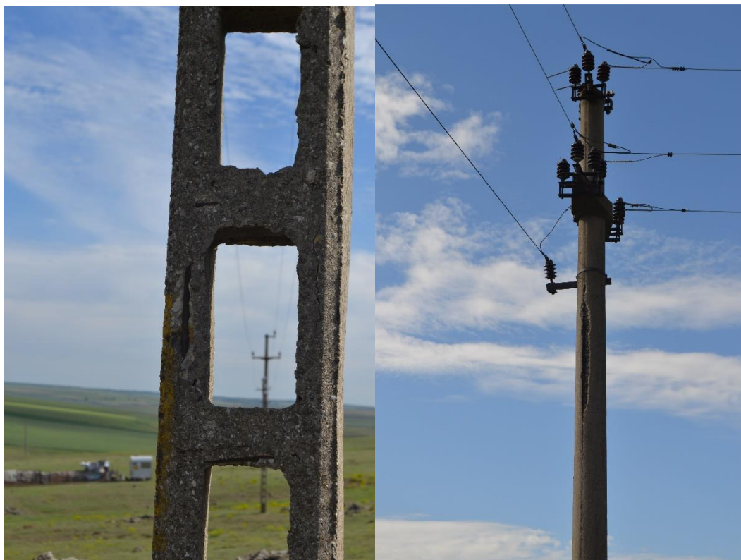
Imagini stalpi fisurati/crapati pe verticala propusi a fi inlocuiti
