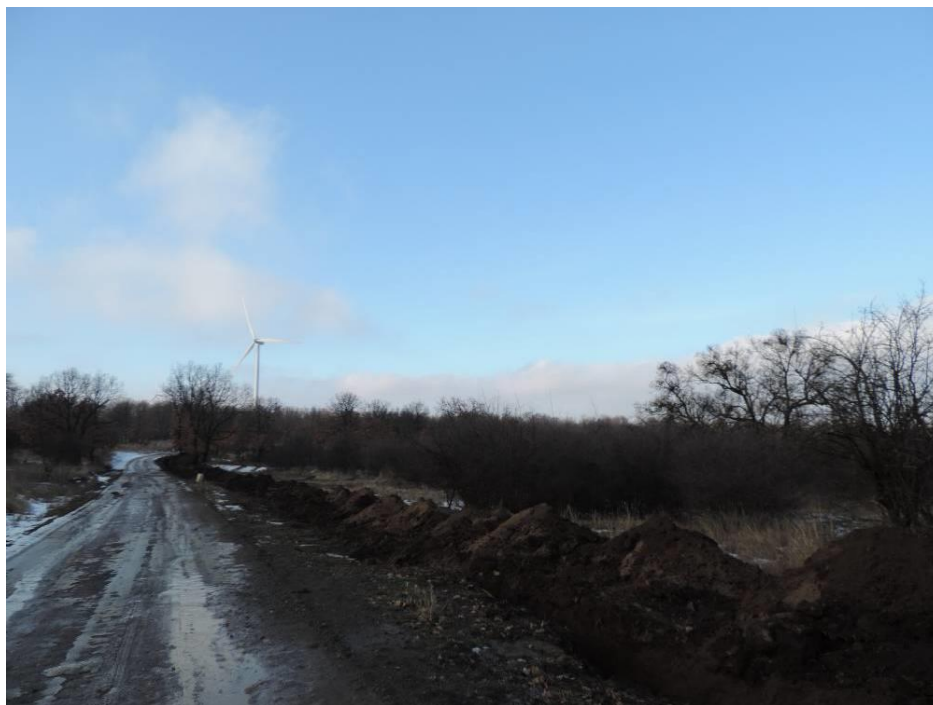
Foto 170 Santuri sapate probabil pentru pozarea cablurilor electrice, la marginea drumului ce intersecteaza padurea de stejar pufos
