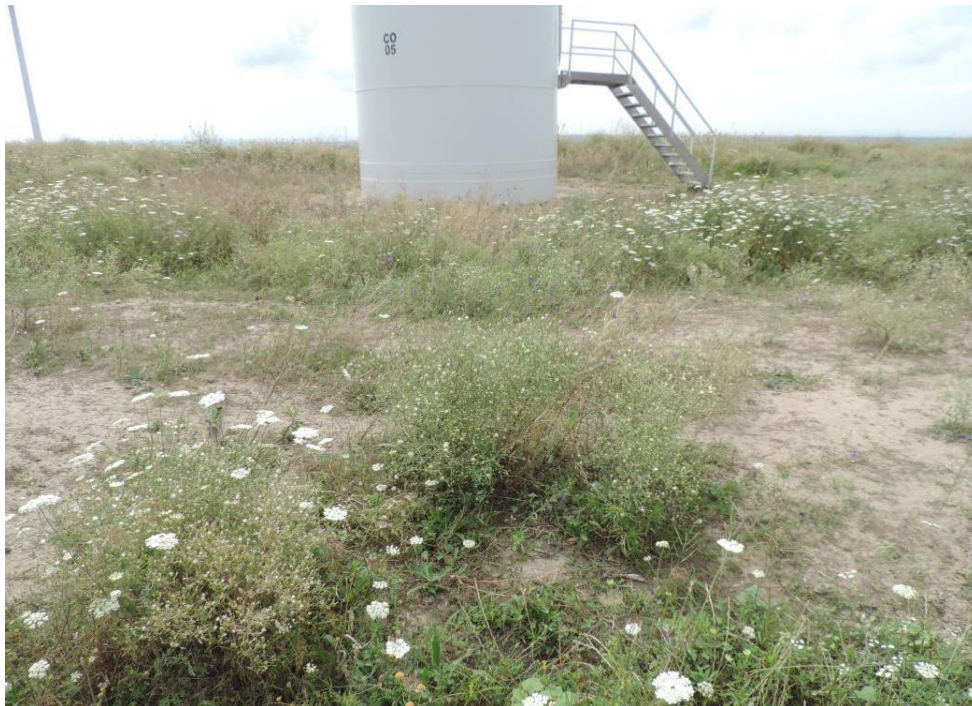
Foto 59 Aspect al vegetației instalate pe platforma tehnologică a turbinei CO_05 (iulie 2014)
