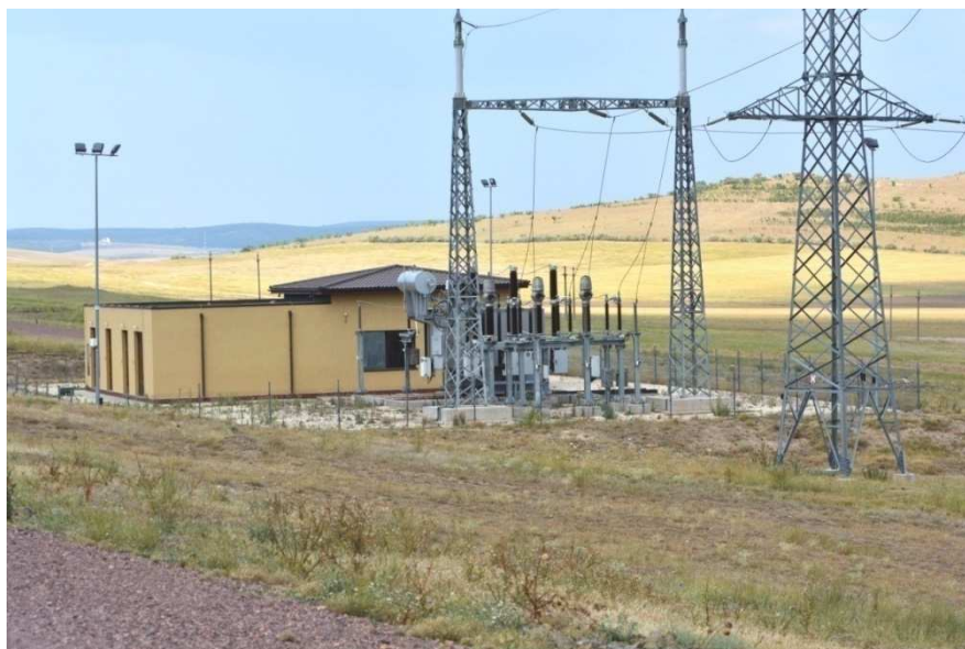
Statia de transformare
