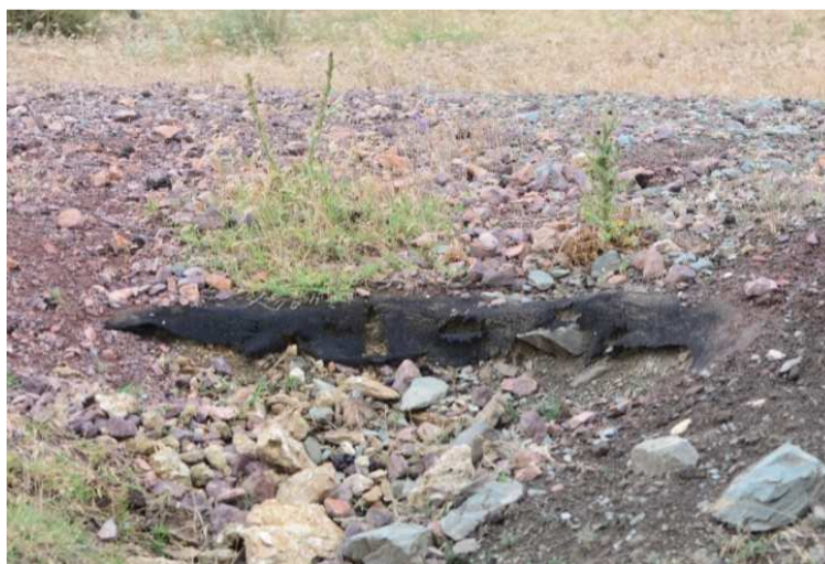
Aspect al deteriorarii drumurilor din cadrul amplasamentului
