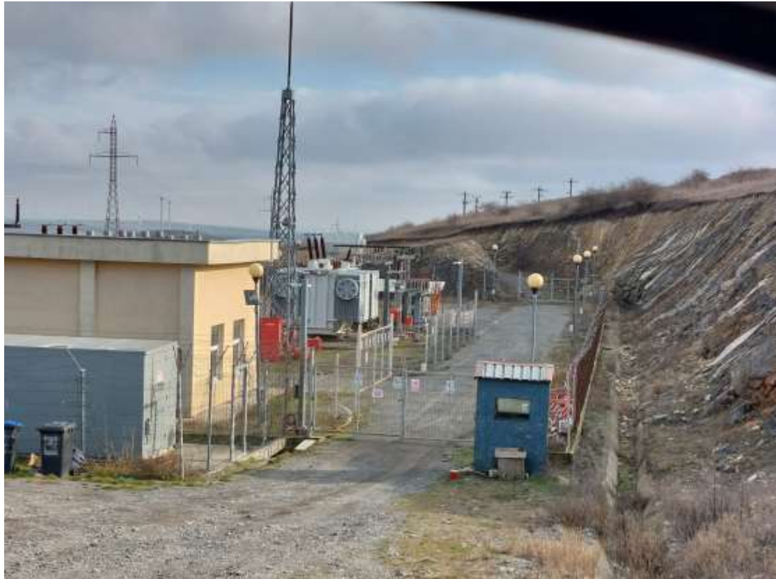
Statie de transformare existenta ( Enel Green Power )
