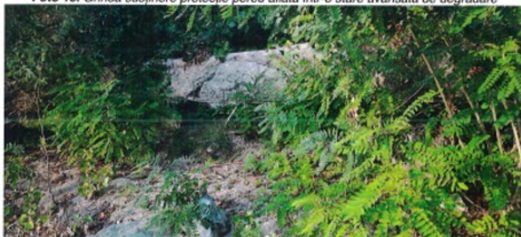
Foto 14. Grindă susținere protecție pereu aflată într-o stare avansată de degradare
