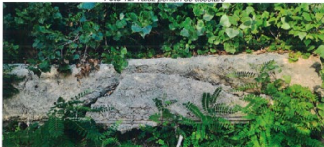
Foto 13. Grindă susținere protecție pereu aflată într-o stare avansată de degradare
