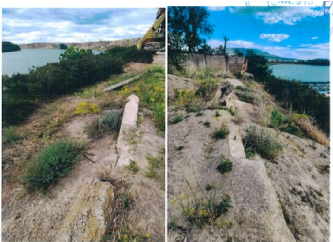
Foto 10. Protecție pereu și gridă beton distruse pe o lungime de cca. 200 ml
