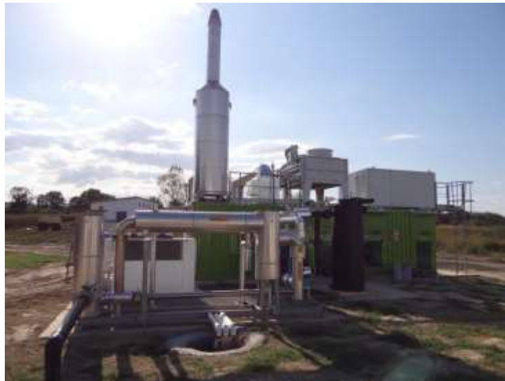
Fig. 7 – imagine instalatie de biogaz BIOCARNIC ESCO SRL
