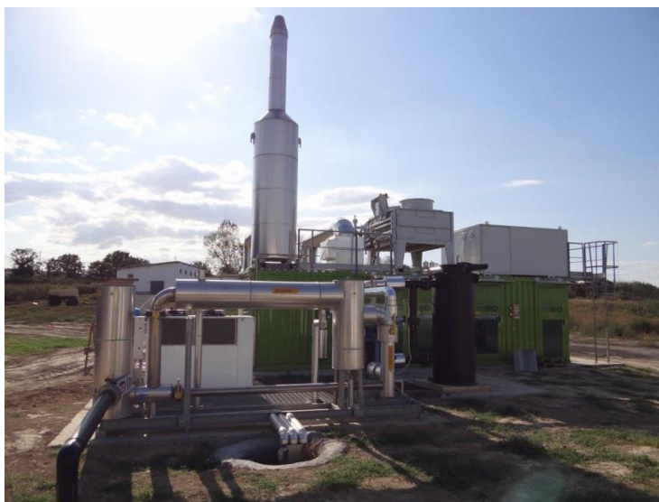
Fig. 7 – imagine instalatie de biogaz BIOCARNIC ESCO SRL
