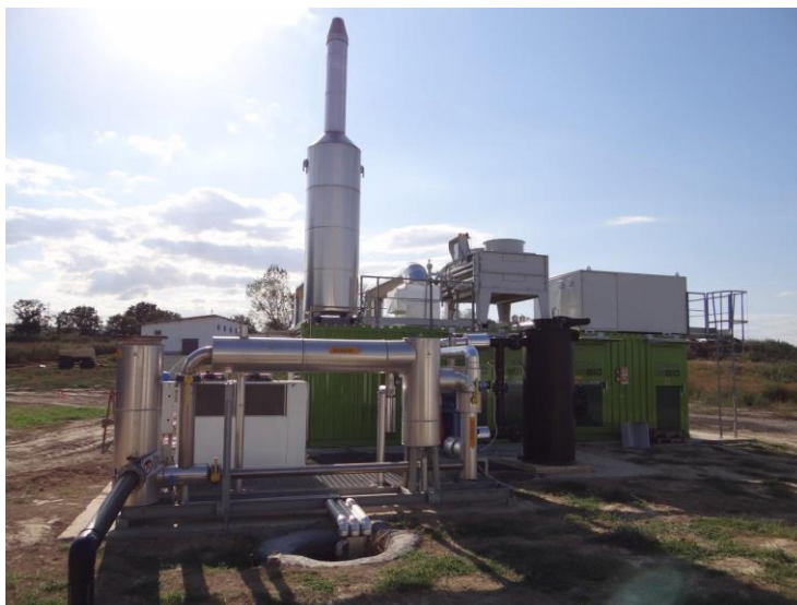
Fig. 7 – imagine instalatie de biogaz BIOCARNIC ESCO SRL
