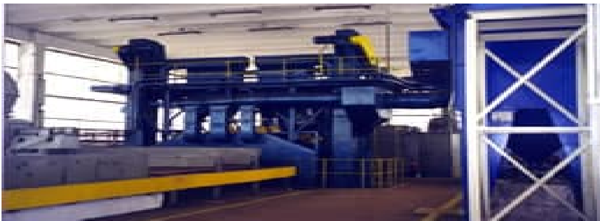
Figura 11 – Linia de sablare – vopsire (pasivizare) – Sectia Debitare
