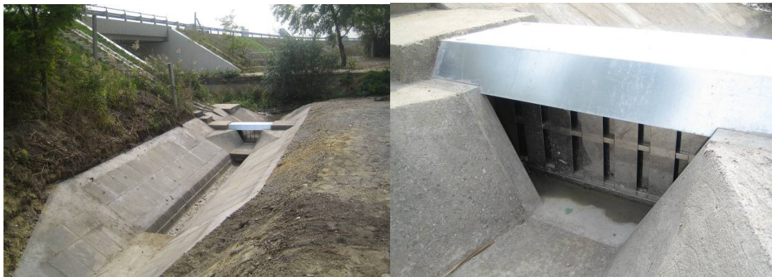
Figura nr. III.6.1 – 1 Separatoare de hidrocarburi
