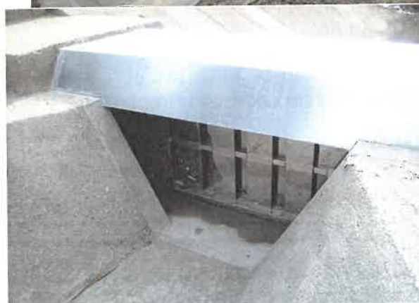
Figura nr. III.6.1 – 1 Separatoare de hidrocarburi
