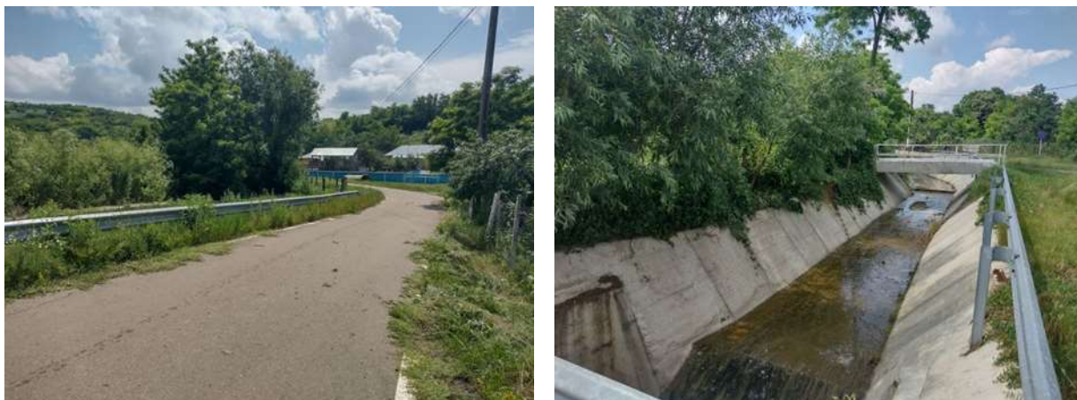
Figura 92 Detalii cu privire la zonele in care lucrarile propuse intersecteaza situl ROSCI0330 Osesti – Barzesti (sat Barzesti)
