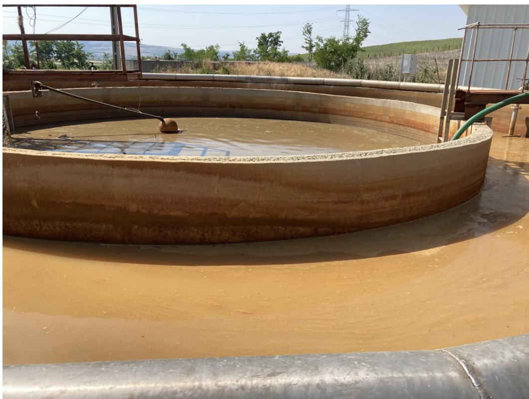
Statia de epurare ape uzate – treapta biologica
