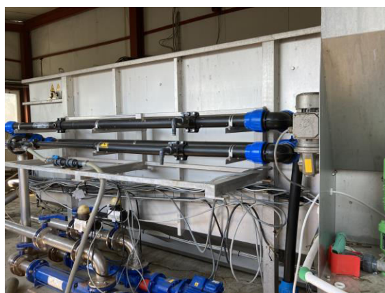
Statia de epurare ape uzate – treapta fizico-chimica
