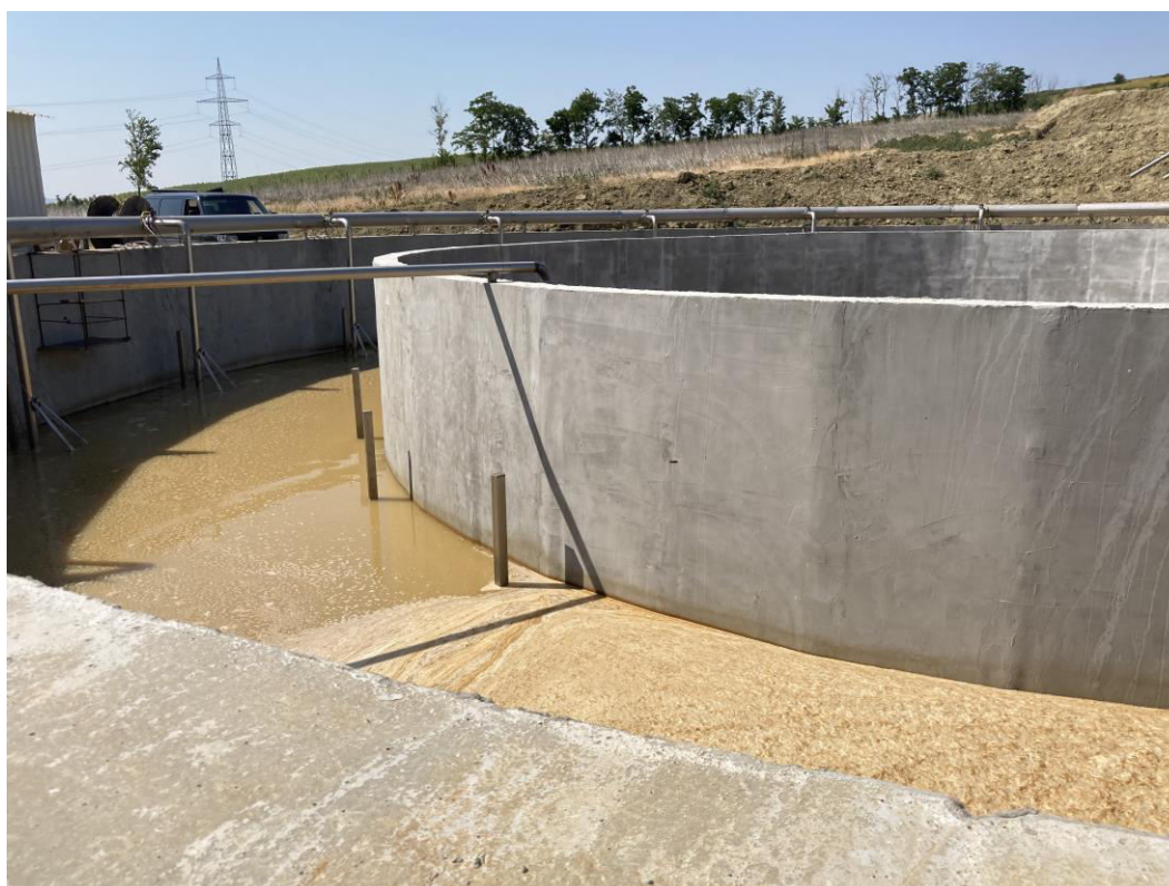
Statia de epurare ape uzate – treapta biologica
