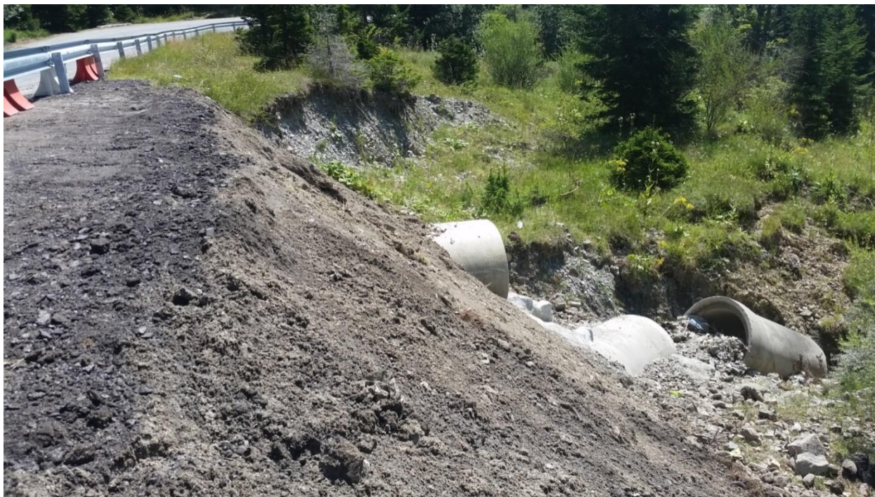
Figura 31 – Încercarea de stabilizare a taluzului DN 71 prin lărgirea acostamentului cu contraforturi de pământ și drenuri, lângă pajiștile habitatului 6440, în sudul Poeniei Hoților.
