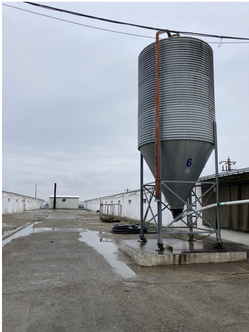
Vedere centrală termică aferentă halelor C7, C9
