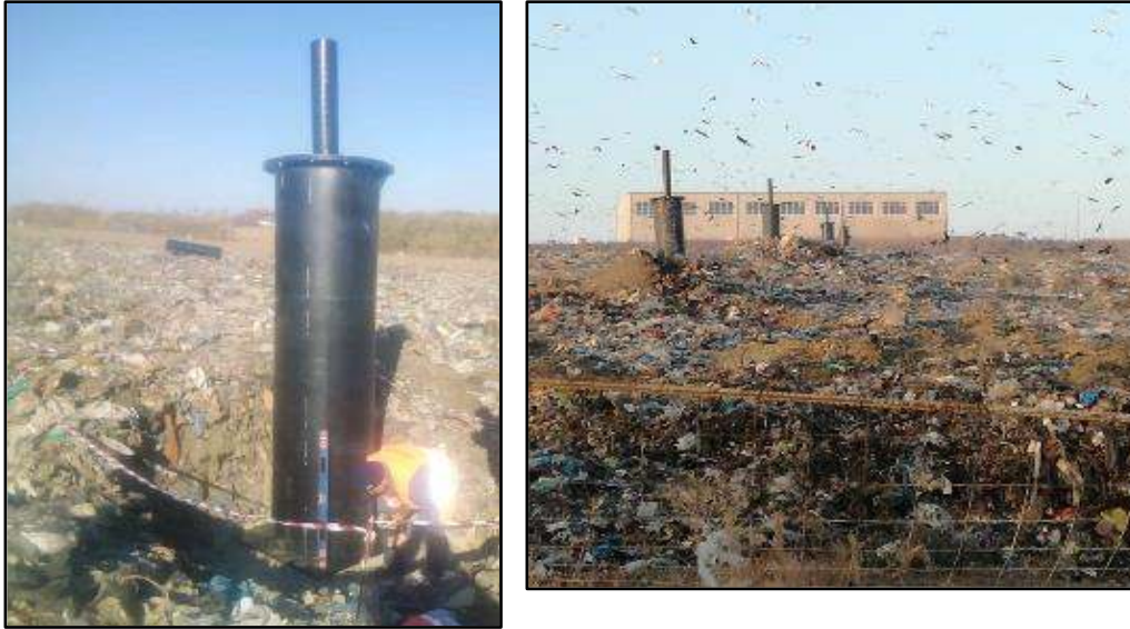
Figura 6 Imagini puțuri de biogaz instalate în celula 1 de depozitare
