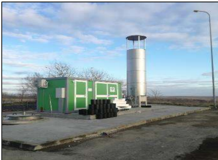
Figura 8 Instalația de extracție și ardere a gazului de depozit
