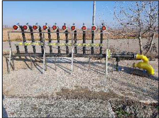
Figura 7 Substație colectare gaz de depozit
