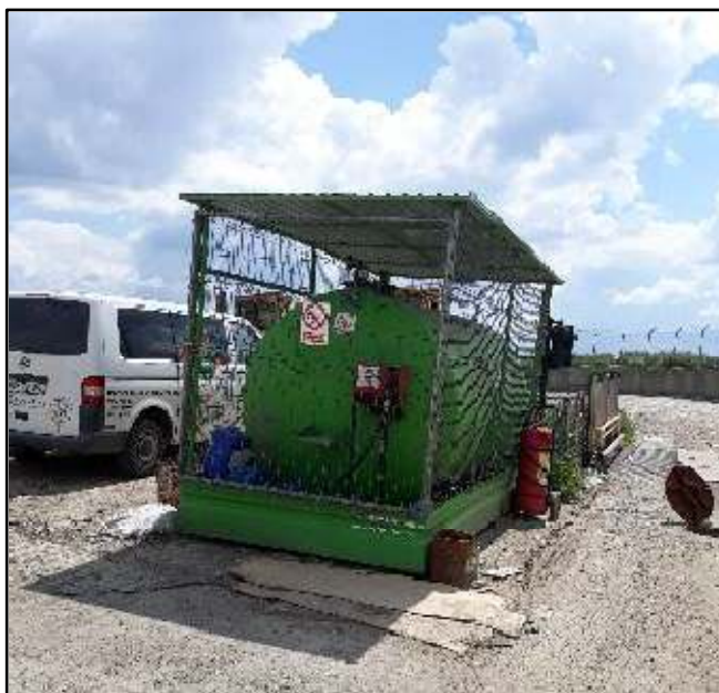
Figura 22 Rezervorul pentru combustibil
