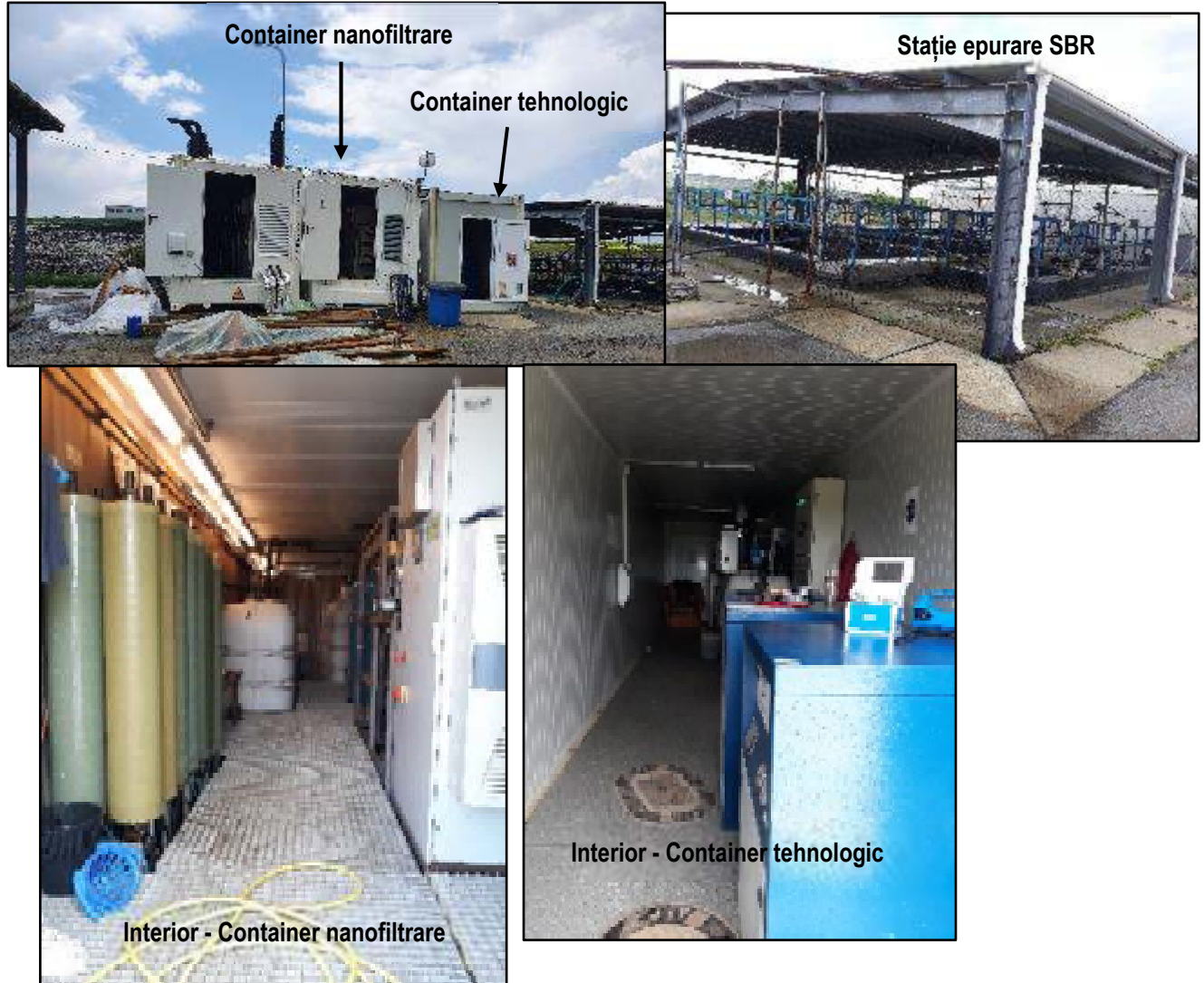
Figura 24 Stație de epurare SBR și nanofiltrare (NF)
