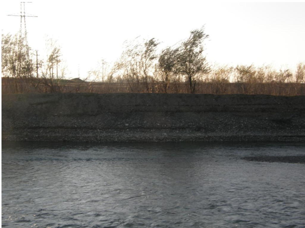
Eroziune mal drept în zona propusă pentru decolmatare
