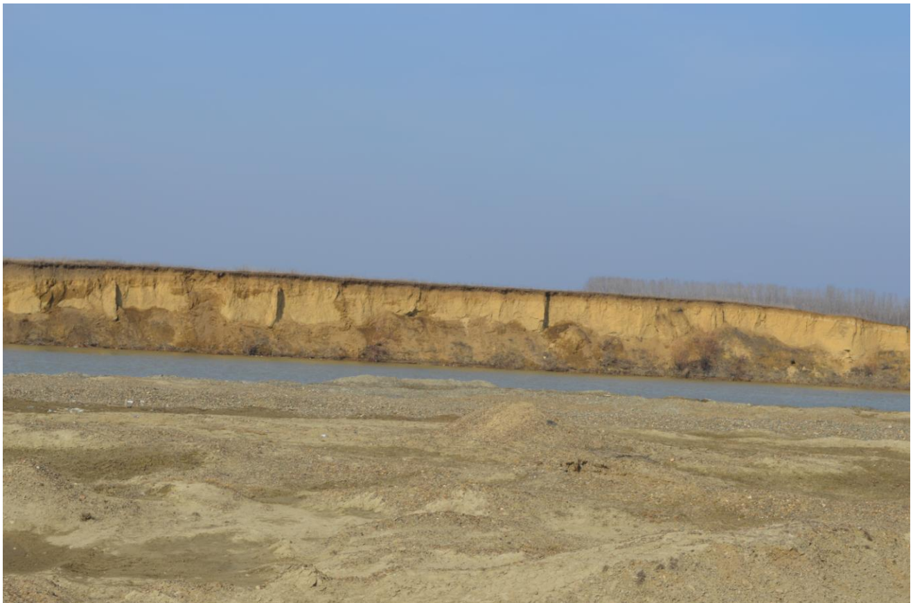
Eroziune a malului opus perimetrului SIMA
