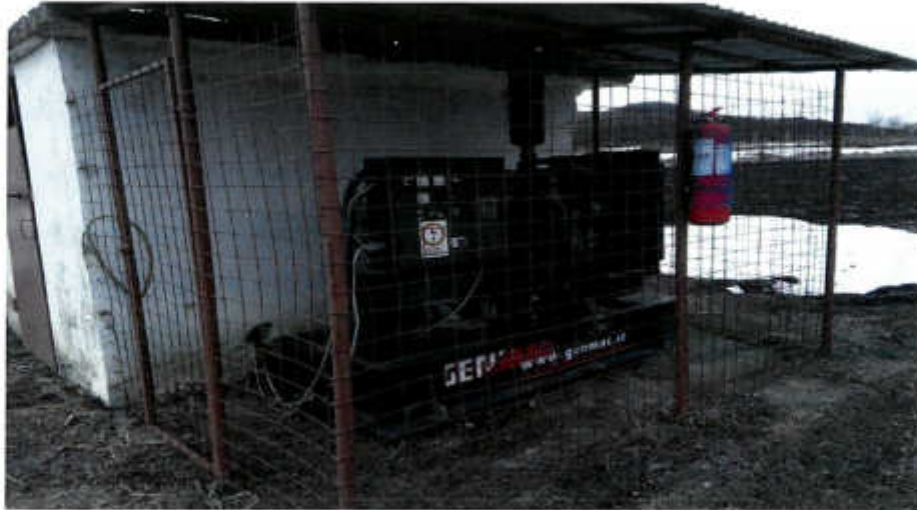
Amplasarea generatorului electric
