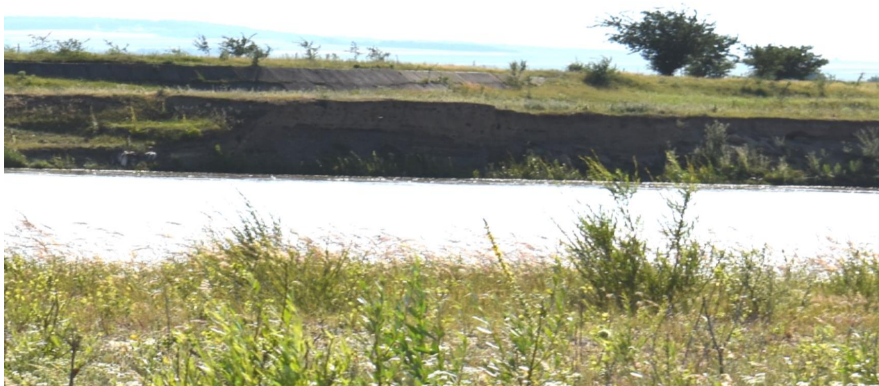
Figura 13: Eroziune mal drept râu Moldova în dreptul perimetrului La Păstrăvărie
