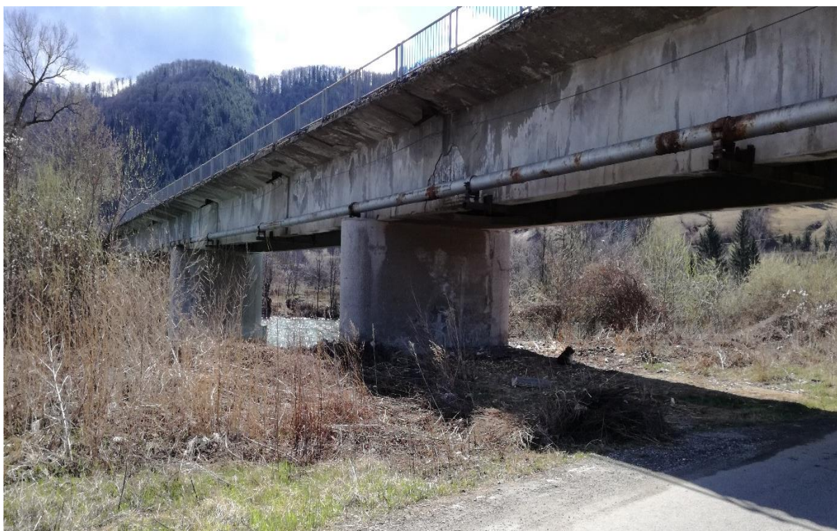
Figura nr. 1. Vedere asupra traversării aeriene, conducta DN 300 Piatra Neamț - Bicaz ancorată de podul rutier existent pe drumul național DN15 Turda-Bacău
