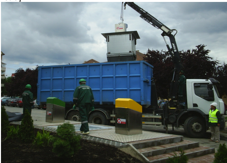
Fig. 6.6.5.1. Container subterane pentru deșeurile de hârtie-carton, sticlă și plastic -Mediaș
