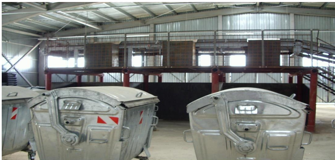
Fig VII.1.1.5. Stația de sortare pentru deșeurile menajere –SC Eco Valea Hârtibaciului SA Agnita
