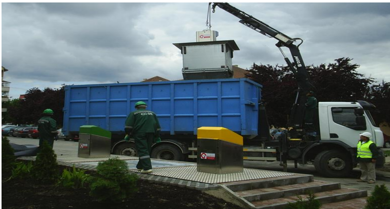
Fig. VII.1.1.3. Containere subterane pentru deșeurile de hârtie-carton, sticlă și plastic - Mediaș
