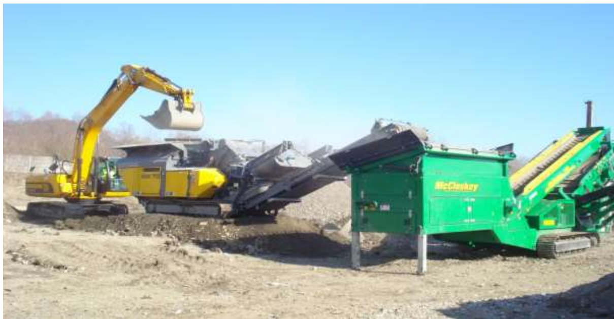
Fig. VII.1.1.6. Stație de preluare și prelucrare a deșeurilor provenite din construcții și demolări - Mediaș
