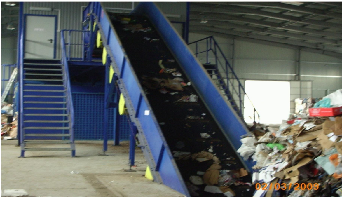
Fig. VII.1.1.4. “Stația de sortare și transfer pentru deșeurile menajere” din municipiul Mediaș
