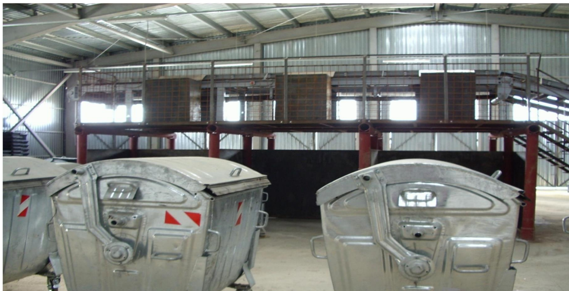
Fig VII.1.1.5. Stația de sortare pentru deșeurile menajere –SC Eco Valea Hârtibaciului SA Agnita
