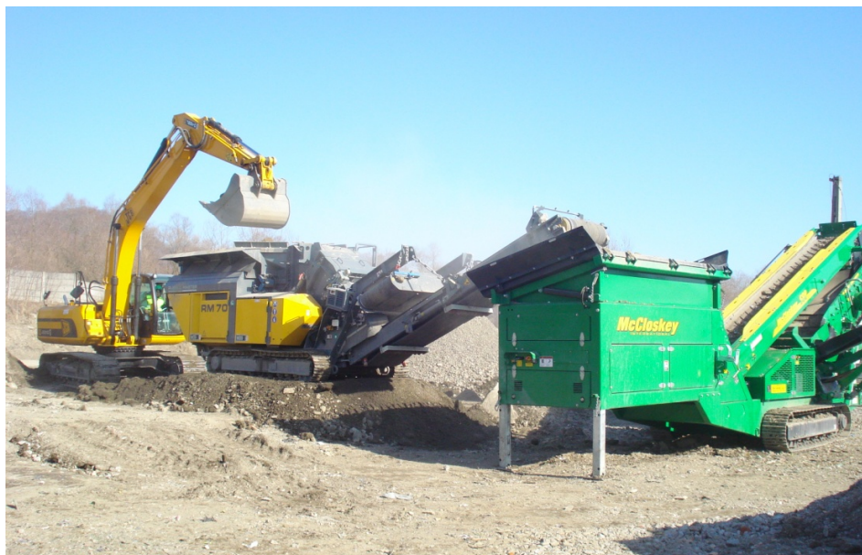
Fig.6.6.4.1. Stație de preluare și prelucrare a deșeurilor provenite din construcții și demolări - Mediaș
