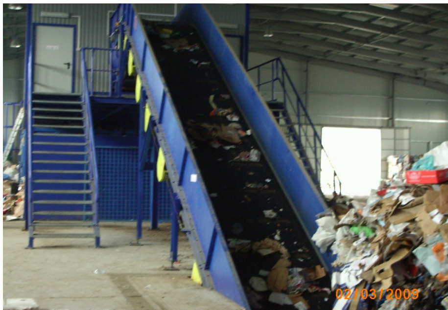
Fig. 6.6.1.2. “Stația de sortare și transfer pentru deșeurile menajere” din municipiul Mediaș
