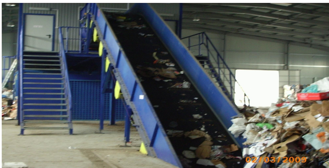
Fig. 6.6.1.2. “Stația de sortare și transfer pentru deșeurile menajere” din municipiul Mediaș
