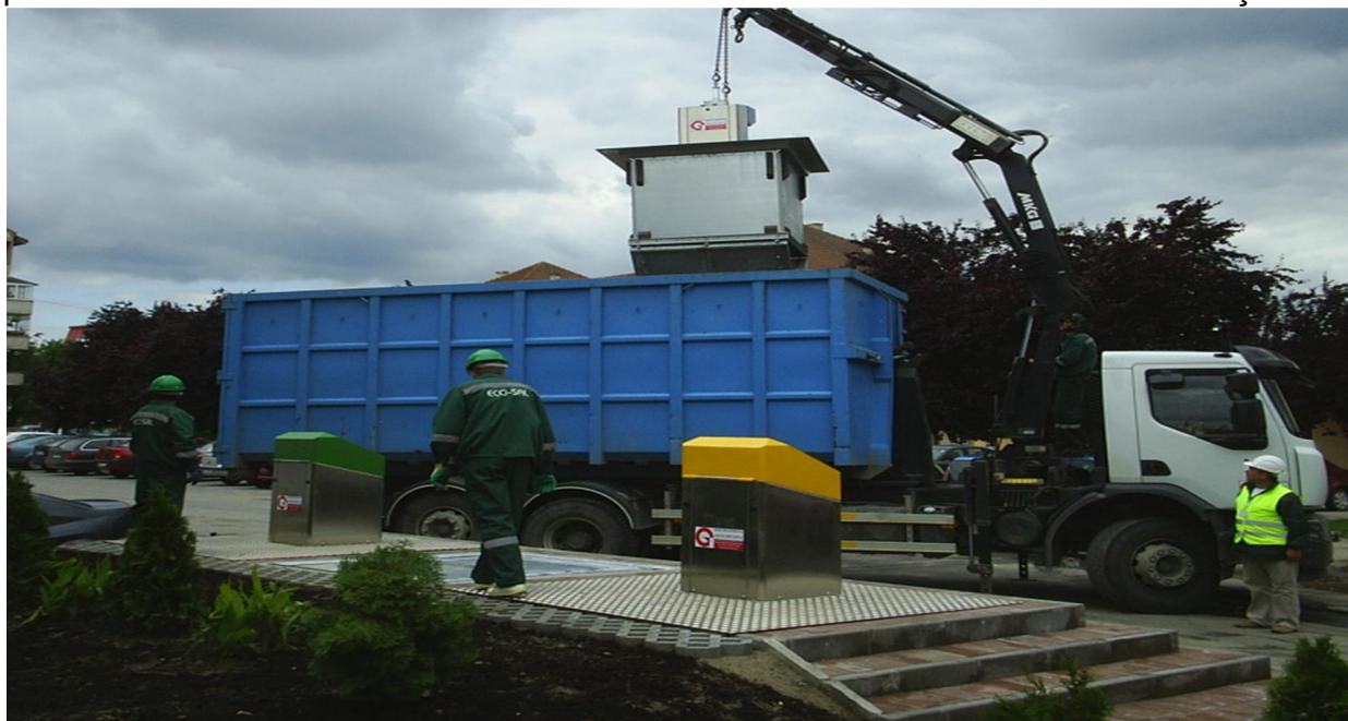
Fig. 6.6.5.1. Container subterane pentru deșeurile de hârtie-carton, sticlă și plastic -Mediaș
