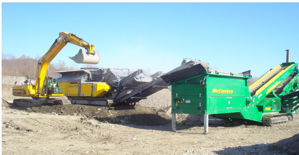
Fig.6.6.4.1. Stație de preluare și prelucrare a deșeurilor provenite din construcții și demolări - Mediaș
