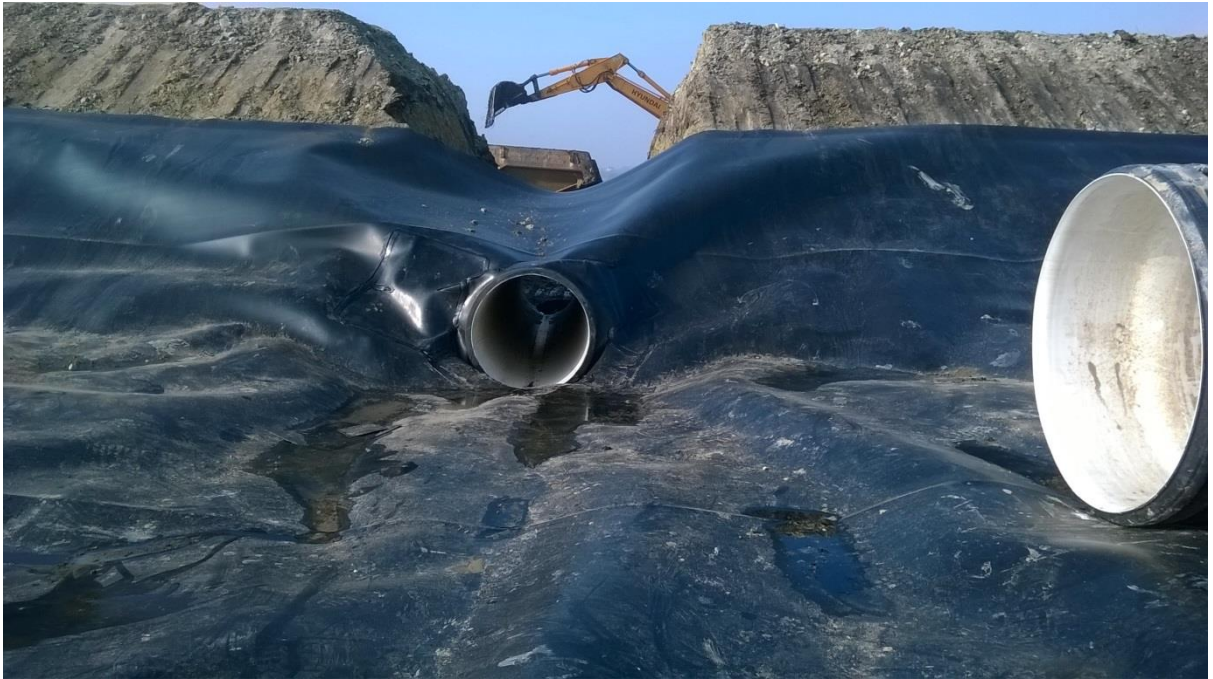
Figură 6. Imagine dispunere sistemului de drenare și evacuare a levigatului
