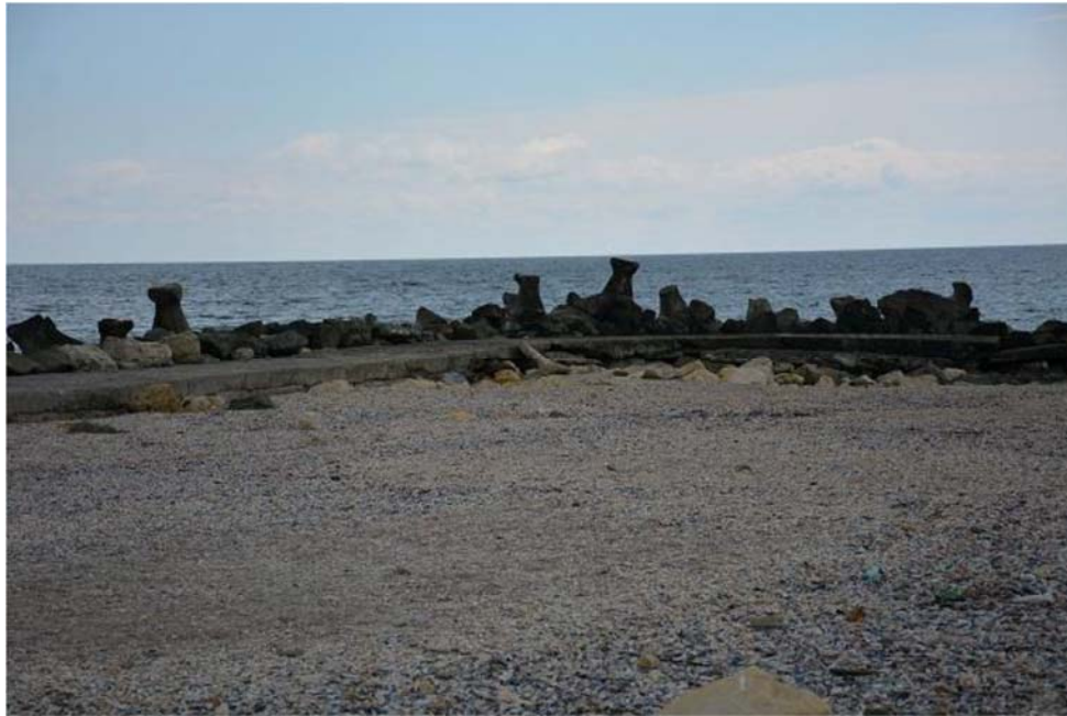
Portiune de dig cu stabilopozi dislocati si dale crapate
