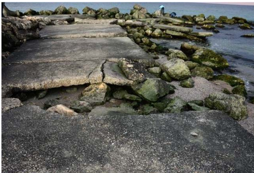
Lipsa dale de beton, nucleu subspalat și manta de protecție destrămată
