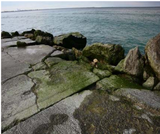
Dezvoltare de alge pe structură
