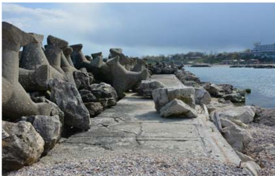
Zona cu blocuri de piatră deplasate, dale crapate
