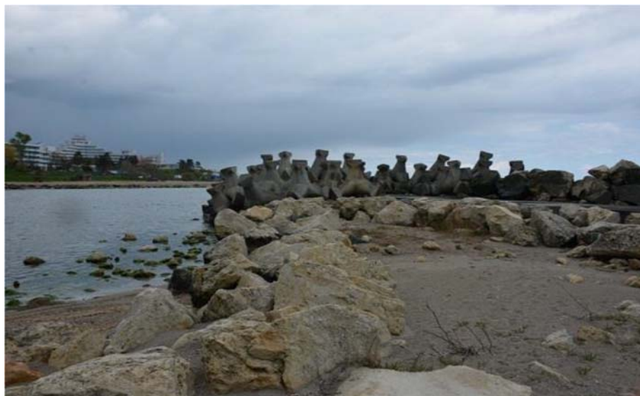
Zona din digul paralel cu linia tarmului cu dale crapate si deplasate, stabilopozi si blocuri de piatra dislocate
