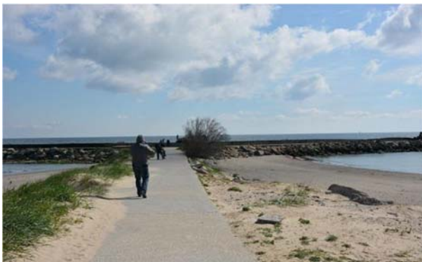
Zona de dig din segmentul perpendicular pe dig port Mangalia cu mantaua de protectia inexistentă și prezenta vegetatiei pe zona de protectie
