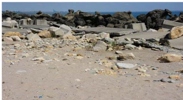
Dale de beton dislocate
