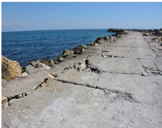
Dale de beton ce prezintă crăpături
