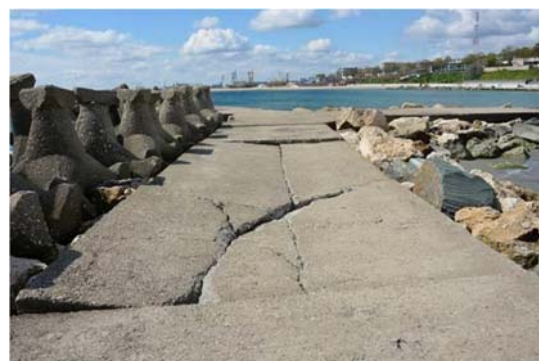
Dale surpate și crapate, blocuri de piatră dislocate din mantaua de protecție pe segmentul de dig paralel cu linia țărmului
