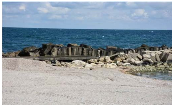
Zona cu blocuri evidente deplasate si nucleul de piatra spalat sub dala de beton
