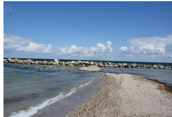
Acumulare de nisip in spatele structurii de protectie si manta din blocuri de piatra dislocate
