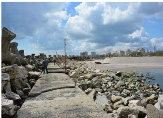
Portiune de dig cu dala crapata si portiuni dislocate, mantaua din blocuri de piatra dislocata
