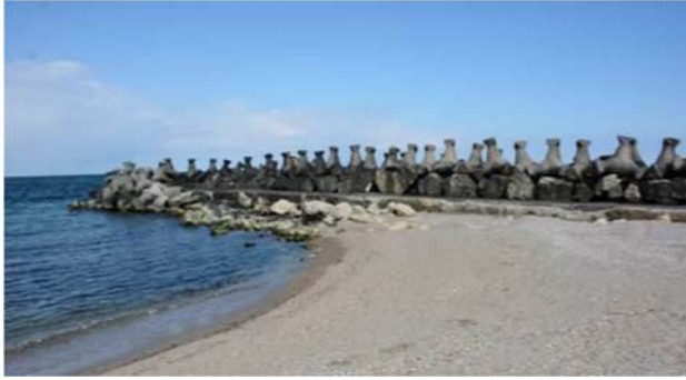
Zona cu stabilopozi deplasati
