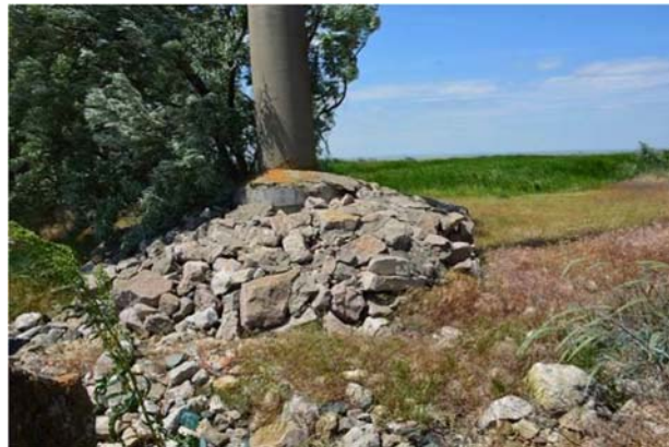
Stâlp de electricitate situat pe malul canalului ce necesită protecție
