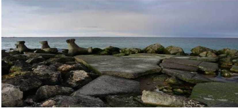
Zone cu dale din beton crapate și dislocate
