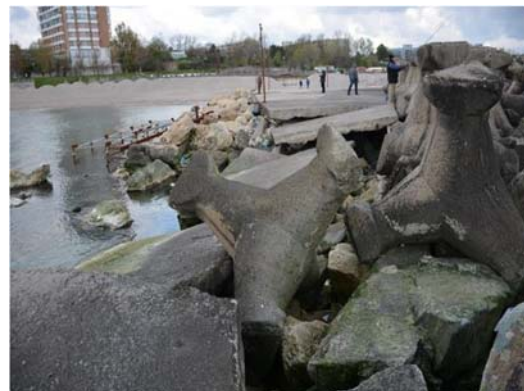
Portiune de dig cu dale deplasate, Subspalari ale nucleului si stabilopozi deplasati
