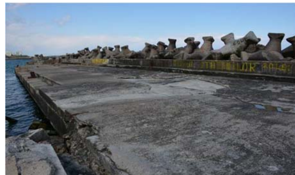
Zona cu dale crapate, stabilopozii deplasati pe segmentul de dig paralel cu linia tarmului
