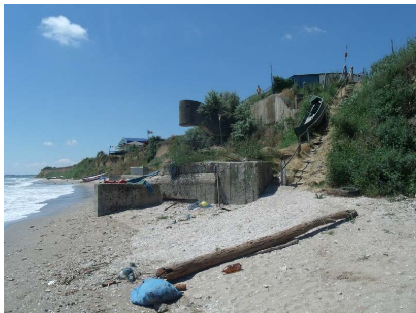
Exemplificare eroziune costiera - Cazemata zona faleza Costinesti
