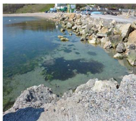
Destramarea mantalei de protecție, zone de dezvoltare a algelor
