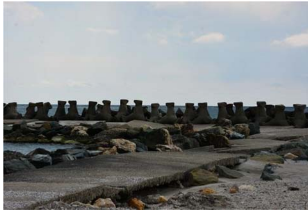
Portiune de dig cu dale crapate si deplasate respectiv blocuri de piatra deplasate
