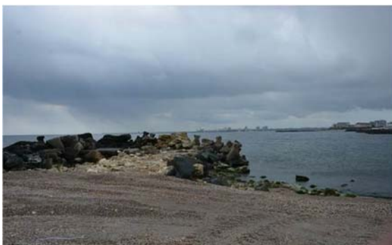
Blocuri de piatra dislocate din mantaua de protectie, completare dig cu piatra nesortata, zone de acumulare a algelor
