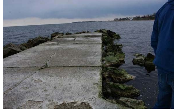
Segment paralel cu linia țărmului cu dale crapecate și manta din blocuri naturale deplăstate
