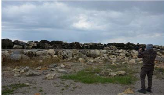
Blocuri de piatră dislocată din mantaua de protecție, vegetație existentă în zona de plajă din interiorul structurii
