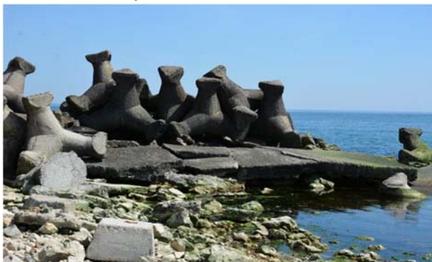
Manta de protecție dislocată dale dislocate și stabilipozi deplasati
