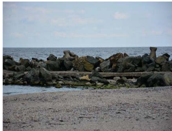
Manta de protecție cu blocuri de piatră dislocate și acumulări de alge
