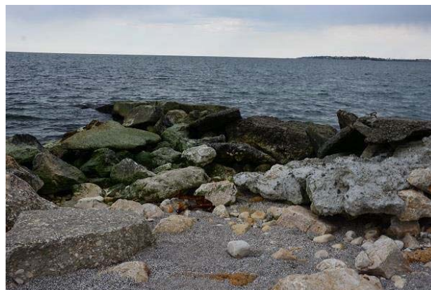
Corp principal structura cu dale deplase, manta dislocate
