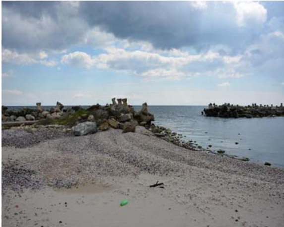
Portiune de dig cu mantaua din blocuri din piatra dislocata si vegetatie pe structura de protectie
