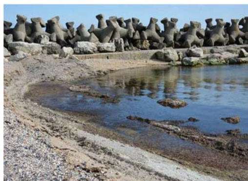
Acumulări de alge, stabilizozi deplasați, blocuri de piatră deplasate
