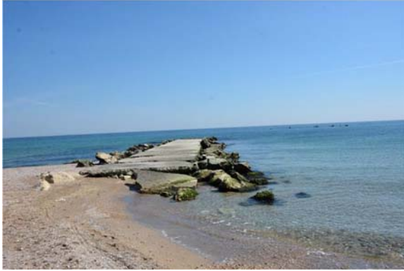
Dale din beton fisurate si dislocate
