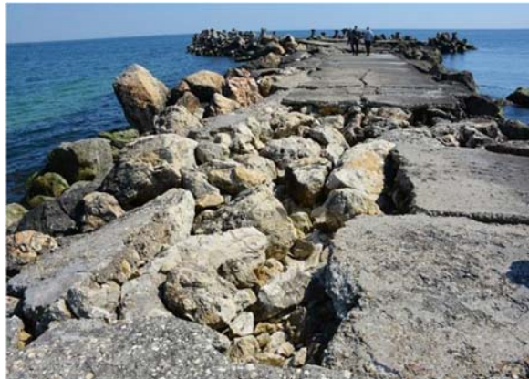
Dale de beton dislocate
