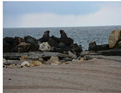
Dale lipsă, blocuri de piatră dislocată din mantaua de protecție
