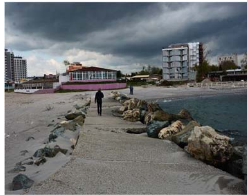
Portiune din segmentul de dig perpendicular pe linia tarmului cu dale crapate si lipsa
