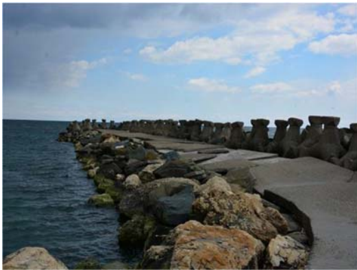
Zona din digul paralel cu linia tarmului cu dale crapate si deplasate respectiv stabilopozii deplasati
