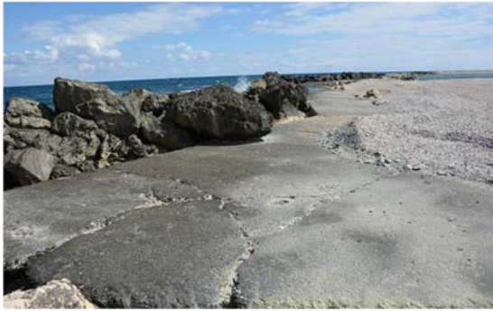
Zona in care dalele de beton prezinta crapaturi
