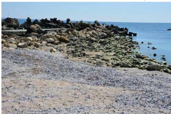
Dale de beton dislocate, stabilipozi deplasati
