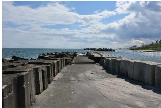
Dale de beton dislocate
