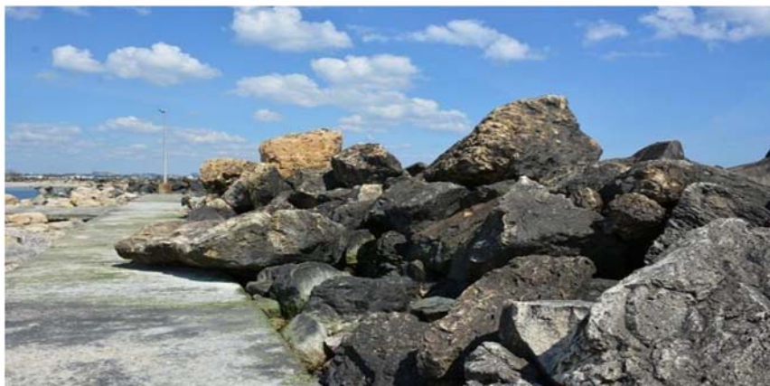
Blocuri din piatra naturala cazute peste dalele de beton
