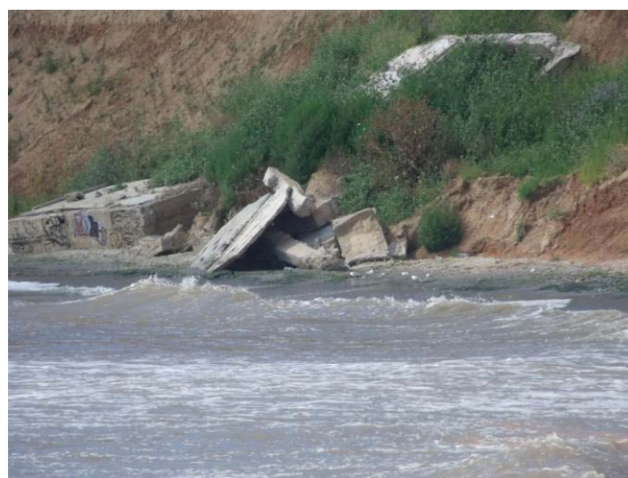
Resturi constructie prabusita datorita eroziunii
