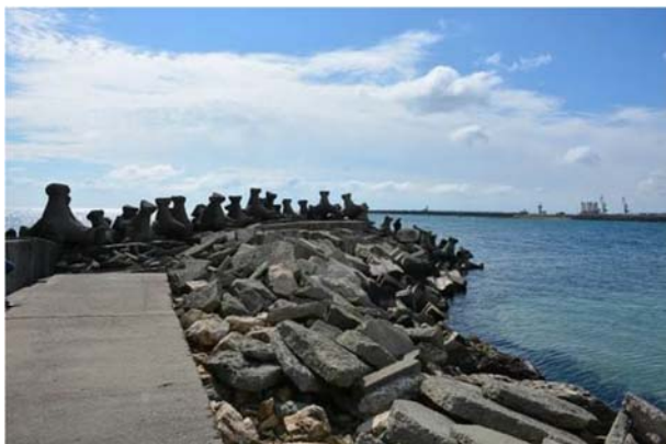
Completari la mantaua de protecție cu reziduri din construcții și stabilopozi în zonele de capăt ale segmentului paralel cu linia țărmului
