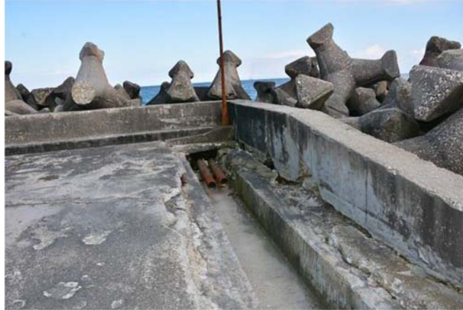
Zona dig cu parapetul din beton crapat, lipsa dale prefabricate de acoperire canal cu
