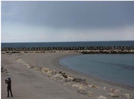
Portiune de dig cu piatra din manta dislocata
