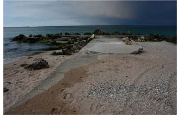
Dala de beton dislocată
