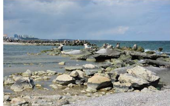
Zona in care structura este distrusa (manta dislocata, nucleu spalat, dale dislocate)
