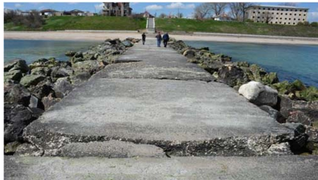
Dale de beton fisurate
