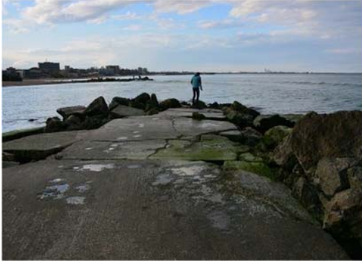
Dale de beton cu crapături și nucleu subpalat
