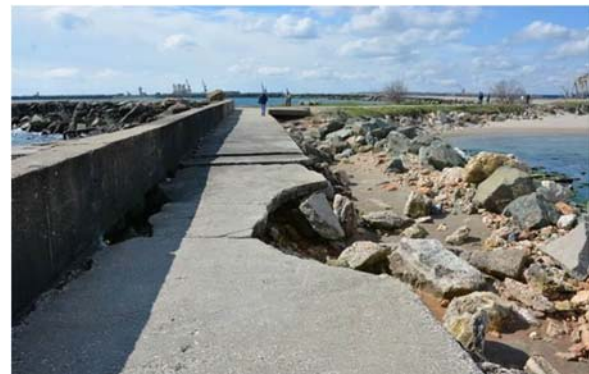
Zona cu dale crapate și lipsa, cu blocuri de piatra dislocate din mantaua de protectie a segmentului de dig paralel cu linia tarmului
