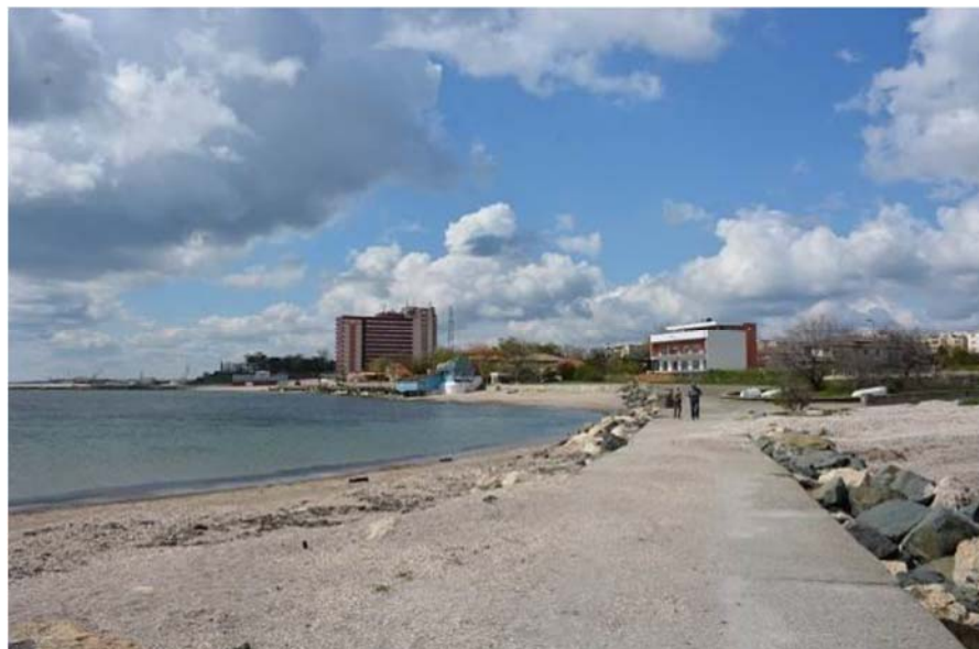
Dislocari ale blocurilor de piatra din mantaua de protectie
