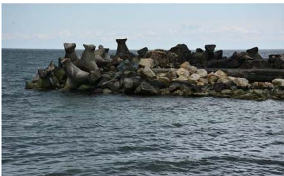
Zona cu stabilizozi deplasati
