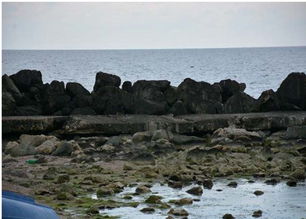
Portiune de dig cu dale crapate, mantaua din piatra dislocata si acumulari de alge
