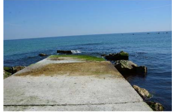
Nucleu de piatra spalat - dala prabusita, destramarea mantalei de protectie si dezvoltare alge
