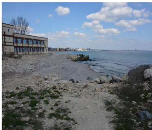
Stabilopozi deplasati și manta de protecție dislocată
