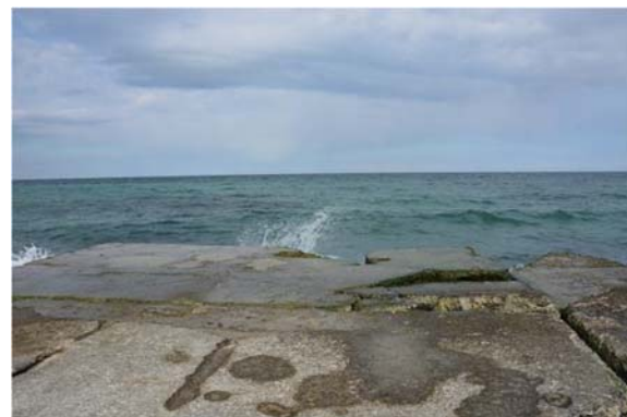
Capul structurii – lipsa manta protectie
