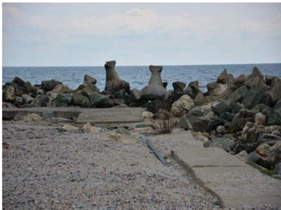
Portiune de dig cu stabilizozi dislocați, dale crapate respectiv dale lipsă
