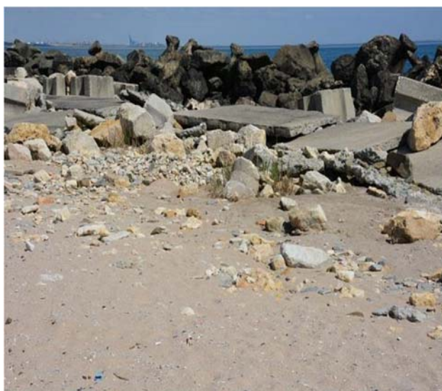
Manta de protectie dislocata si bucati de stabilopozii. Zona de dezvoltare a algelor
