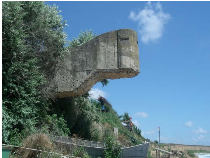
Exemplificare eroziune costiera - Cazemata zona faleza Costinesti
