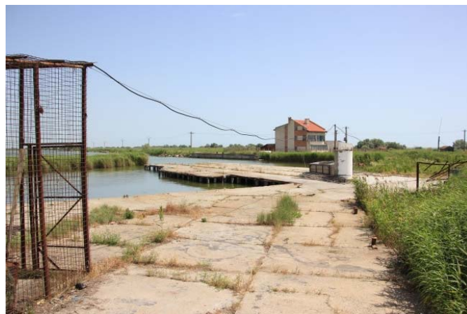
Degradare structuri metalice si beton
