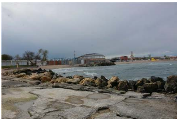
Dale de beton ce prezinta crapaturi
