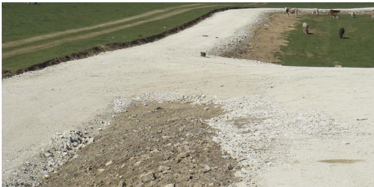
Figura 9. Aspect al unui drum de pământ consolidat cu anrocamente din calcar (zurai)
