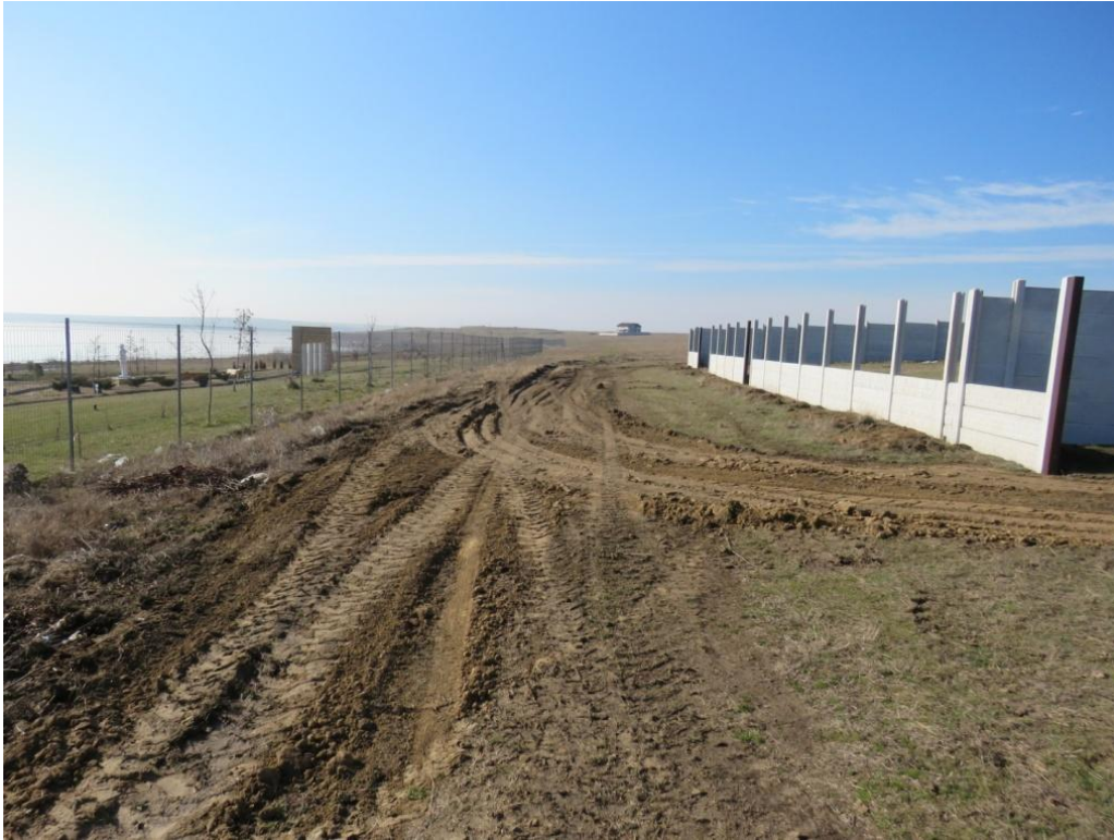
Figura 3 - Amplasamentul proiectului - Strada Lacului , in prezent drum circulat in mod constant de vehicule agricole, autoturisme, tranzitat in mod frecvent de turmele crescatorilor de animale din zona
