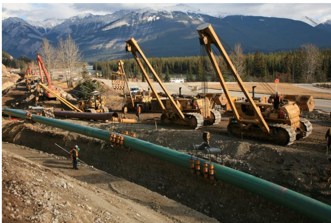
Foto 5: Lansarea conductei în șanț deschis cu ajutorul lansatoarelor de conducte tip TL4
