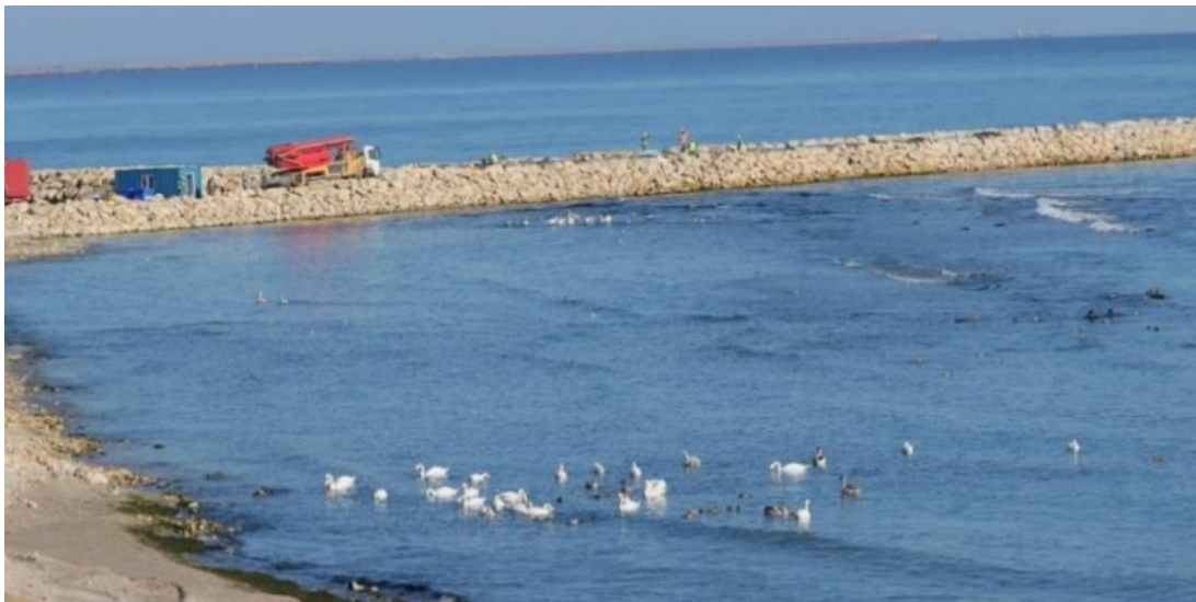
Specii de pasari observate in imediata vecinatate a lucrarilor de constructie – Eforie, 12.11.2021
