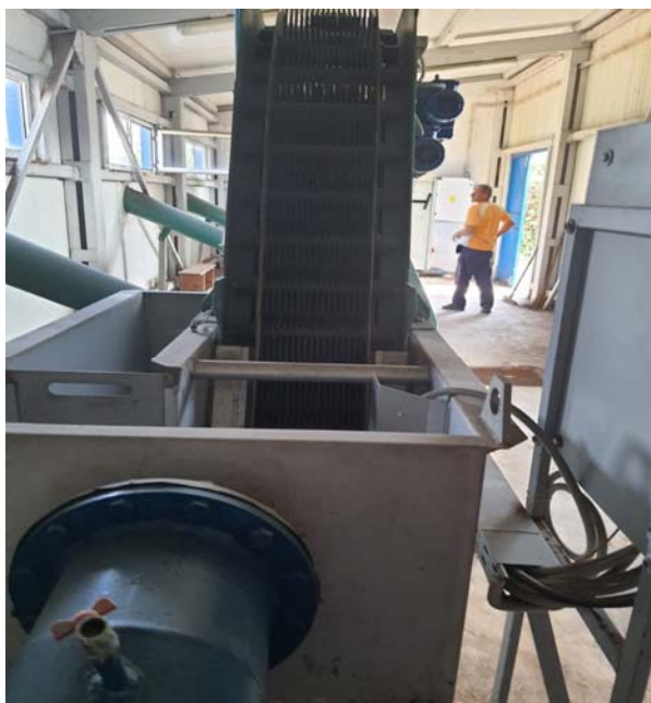
Foto 15. Statia de preepurare – instalatii si echipamente
