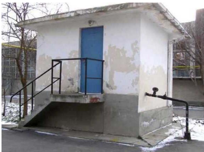
Foto 18. Statie de pompare ape meteorice
