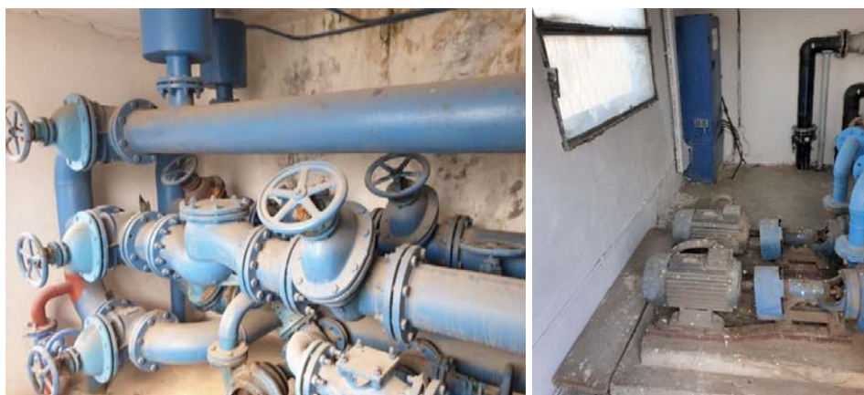
Foto 5. Statie Pompare Apa Potabila
