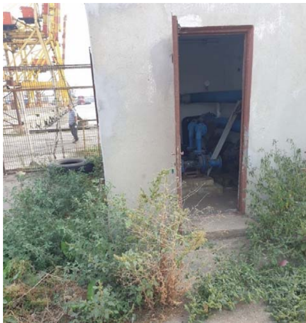
Foto 4. Statie Pompare Apa Potabila
