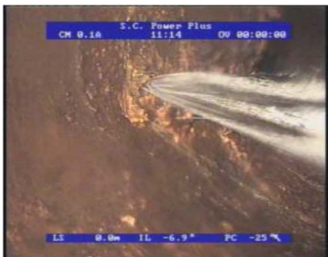
Foto 8. Infiltrație apă din panza freatică într-o conductă de distribuție a apei – investigație CCTV
