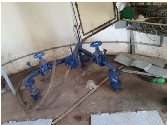
Foto 13. Statii de pompare ape uzate
